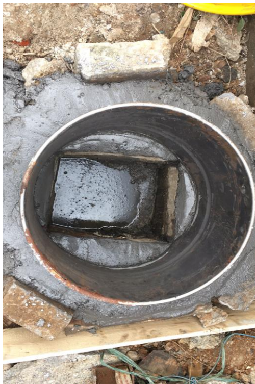
磨渣渗滤液收集池
