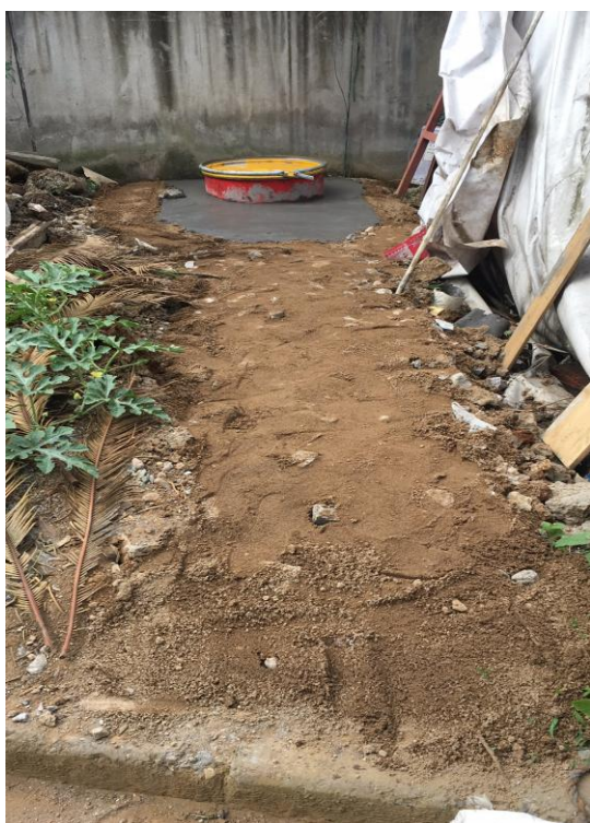
磨渣渗滤液收集池
