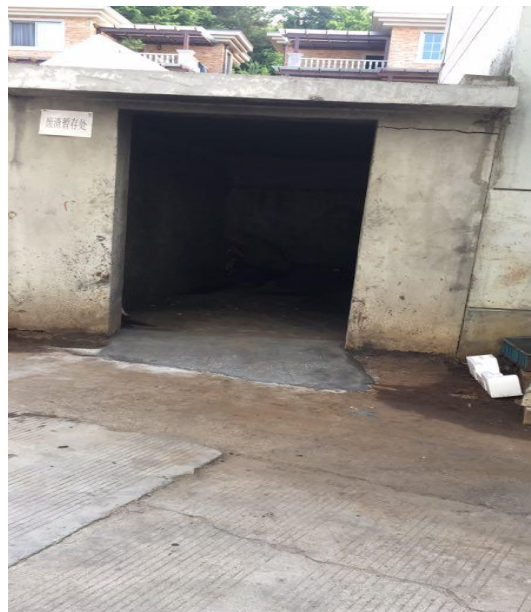
磨渣暂存处内部（整改后）
