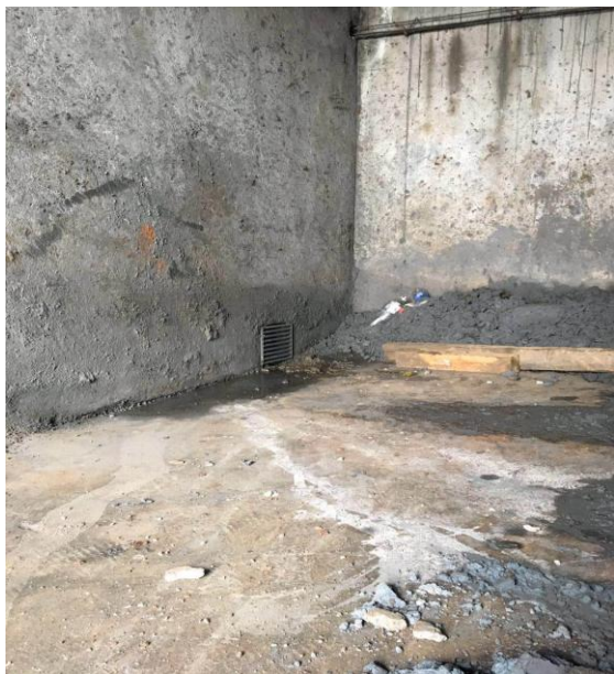
磨渣暂存处内部（整改后）
